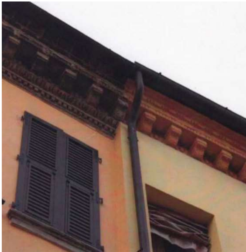
Fig. 4.4 – Exemple d'altération des ouvertures et des décorations résultant d'une intervention de retrofit de l'enveloppe par isolation par l'extérieur [8]
