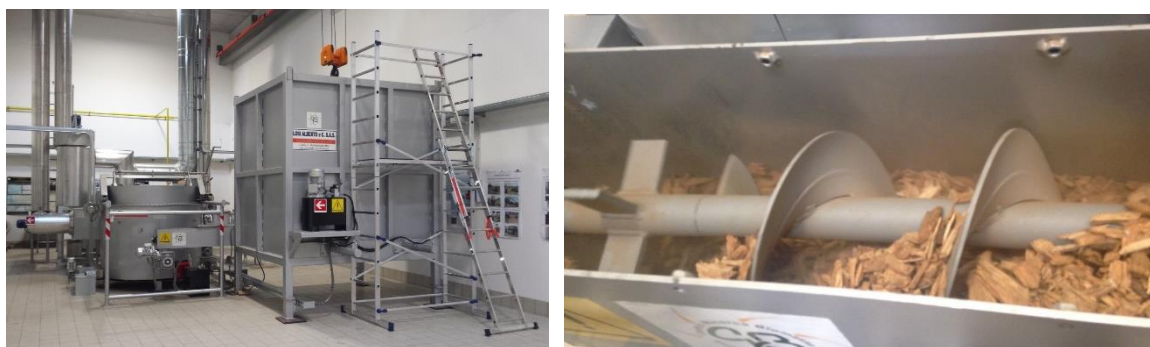
Figura 2. Impianto a biomassa del CRB: visione d'insieme e particolare.
