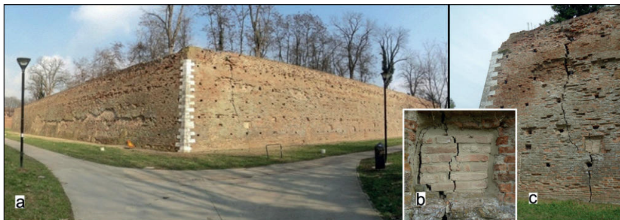
Fig. 1 - Baluardo di Sant'Antonio, parte della cinta muraria della città di Ferrara (a); dettagli delle maggiori fessurazioni presenti (b) e (c).
