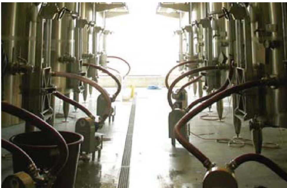
Figura 6.32 Canali di raccolta acque di processo
