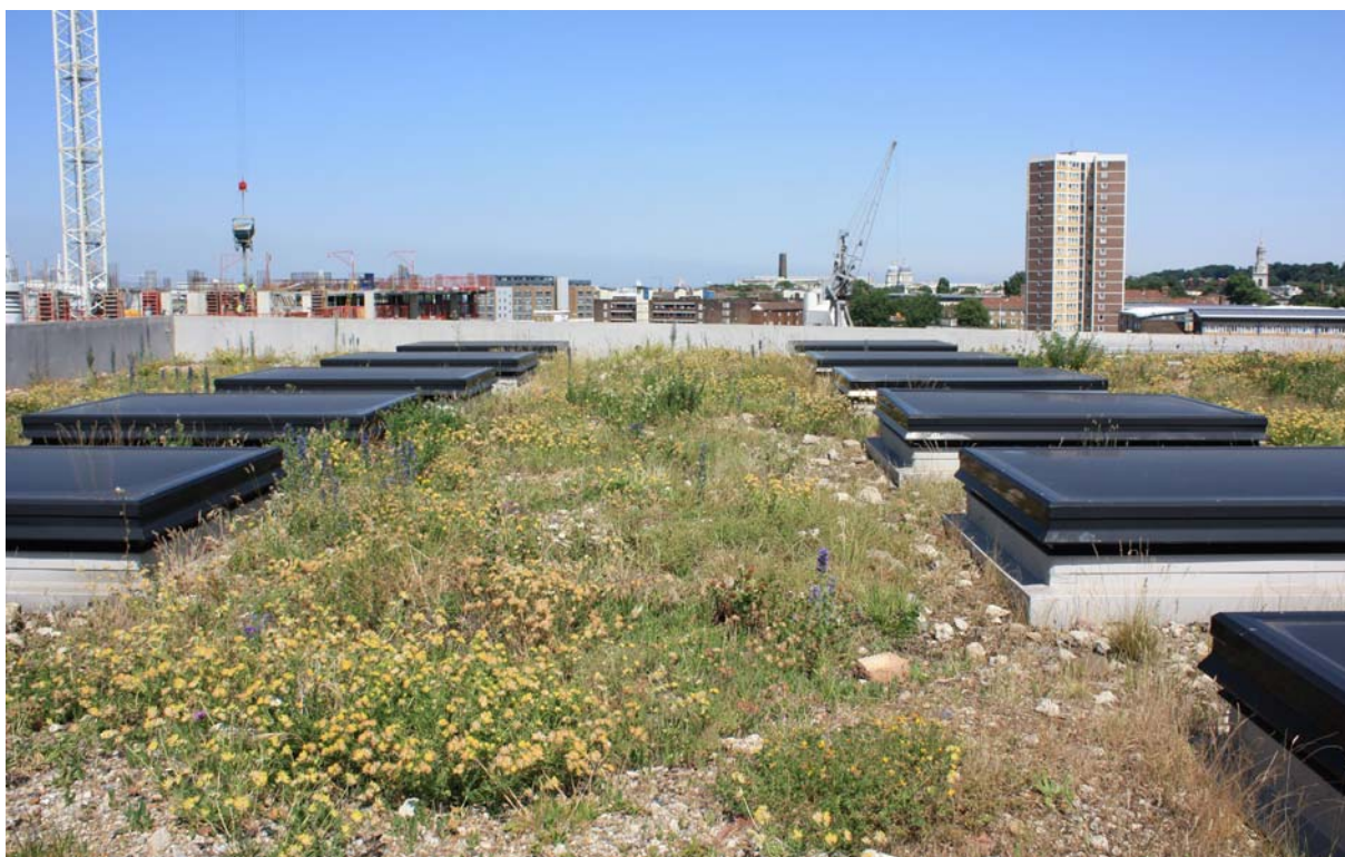
Fig.VI.43 – Esempio di brown roof . Si noti la composizione del substrato prevalentemente ghiaiosa, ed una flora vegetale tipicamente selvatica e molto diversa dalle coperture a verde convenzionali. (Fonte: http://dustygedge.co.uk )
