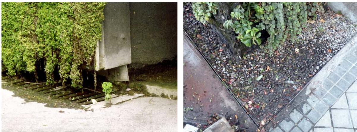
Fig.V.5 – A sinistra. Patrick Blanc, installazione presso il Musée du Quai Branly . Dettaglio dell'attacco a terra. Alla base del muro è stata realizzato un pozzetto di raccolta, in modo da poter re-immettere in circolazione il liquido fertirrigante non utilizzato dall'apparato vegetale. (Fonte: MUSACCHIO, ANTONIO, "Il verde come elemento di chiusura", in bibl., p.187)
