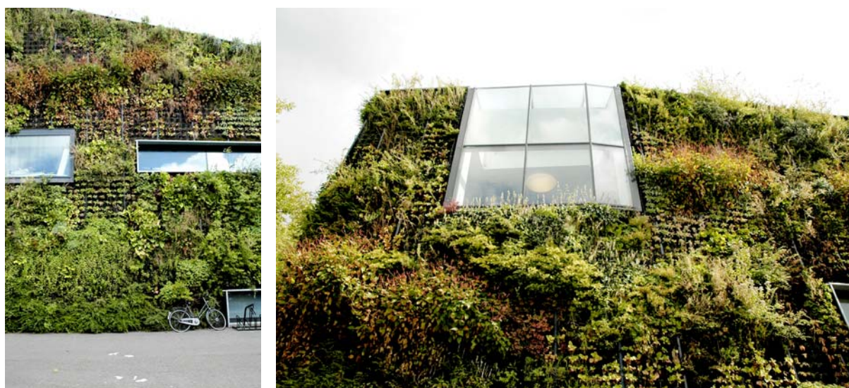
A sinistra. Dettaglio della facciata Ovest: si noti la varietà tipologica dei serramenti. A destra. Dettaglio di una finestra sommitale, poi risvoltante anche in copertura.
