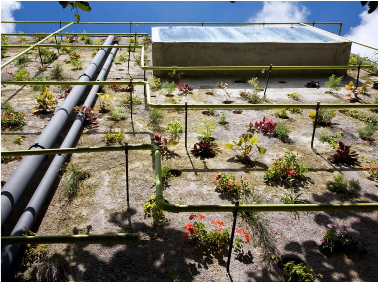
Fig.II.23 – Triptyque, Harmonia 57 , San Paolo (Brasile), 2008. Dettaglio delle chiusure esterne. Le pareti in calcestruzzo armato a vista ospitano delle nicchie circolari per il contenimento di terriccio destinato all'alloggio delle piante: è più che evidente il riferimento alle opere di Lina Bo Bardi. Si vedano anche le immagini del paragrafo VII.2.3, all'interno del settimo capitolo. (Fonte: http://www.archdaily.com )
