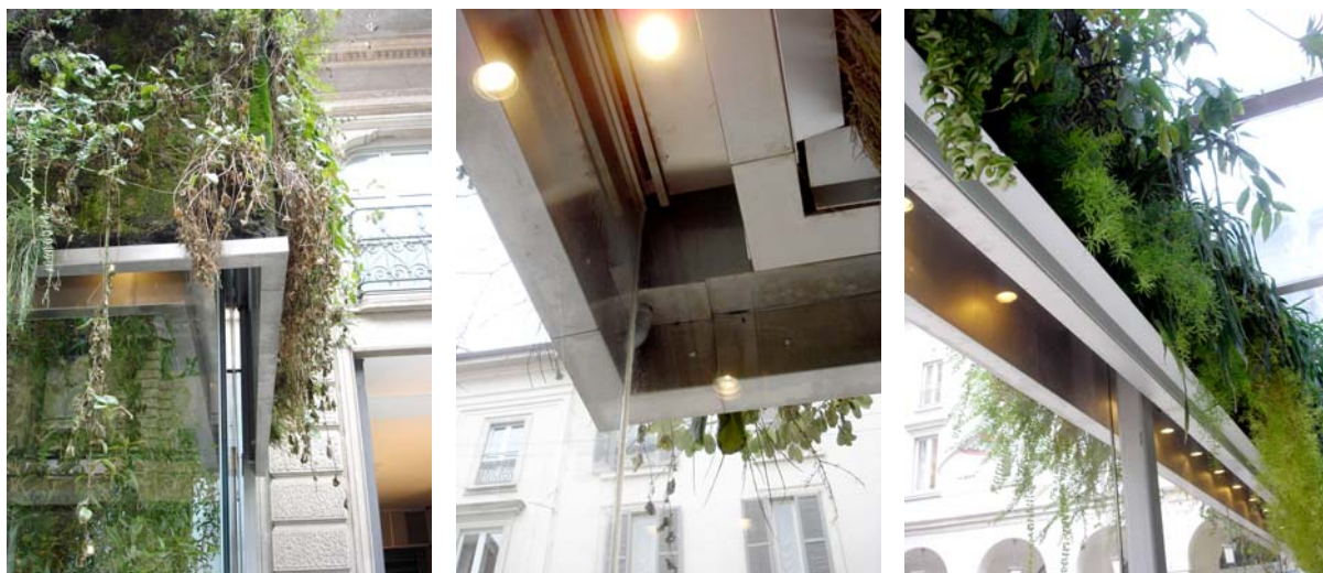
A sinistra: dettaglio della soluzione angolare esterna. Al centro: vista dall'interno dello stesso dettaglio dell'immagine precedente. A destra: vista interna del sistema di drenaggio. Si notino le due grondaie orizzontali – esterna e interna – e il pilastro contenente il pluviale verticale. (E.B.)
