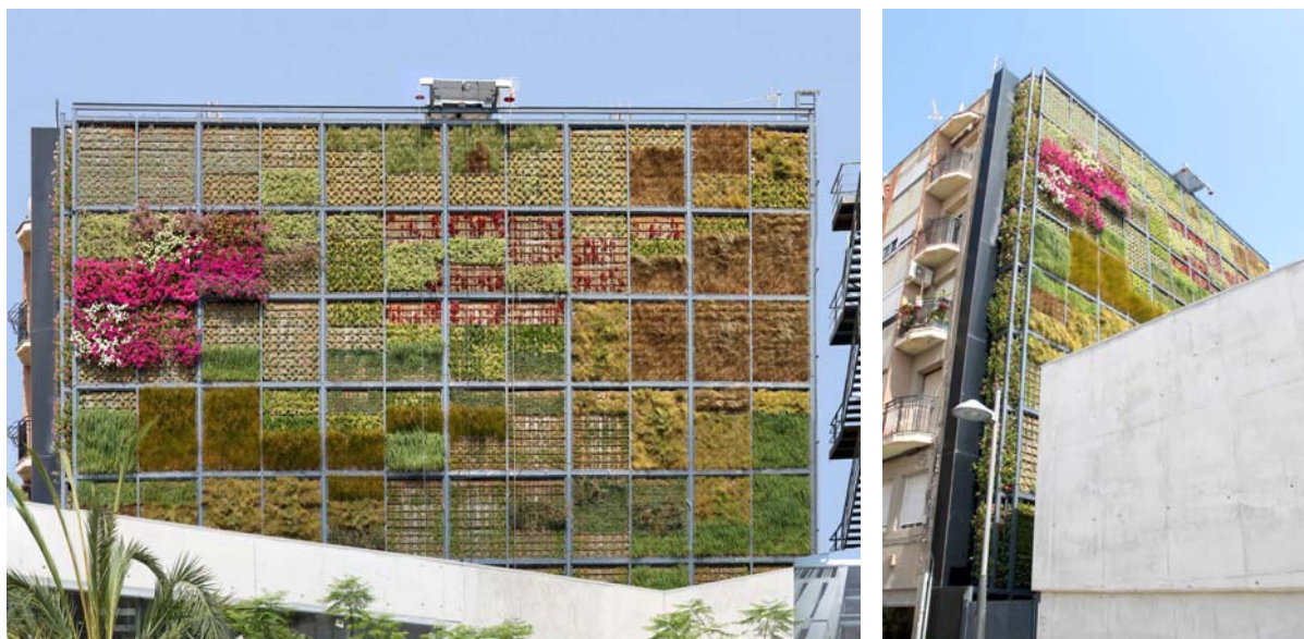
Fig.V.84 – Jose Maria Chofre, parete vegetata presso la biblioteca di San Vicente del Raspeig (Spagna), 2010. Dei pannelli non prevegetati e contenenti substrato granulare sono messi in opera tramite un reticolo metallico connesso alla parete cieca di un edificio: trattasi quindi di un’opera di retrofitting architettonico e urbano (cfr. VII.2.1). In sommità della parete, presso il centro della stessa, è visibile l’ascensore sospeso finalizzato sia all’impianto dei vegetali che alla loro manutenzione. L’opera, delle dimensioni approssimative di 10x30 m, risulta degna di nota perché dimostra come un’installazione vegetale possa ingentilire la facciata cieca di un manufatto. Interessante anche dal punto di vista della collocazione ambientale: il clima nel Sud della Spagna è caldo e arido, quindi la selezione delle piante dovrà essere effettuata con estrema attenzione. (Fonte: http://en.urbarama.com )
