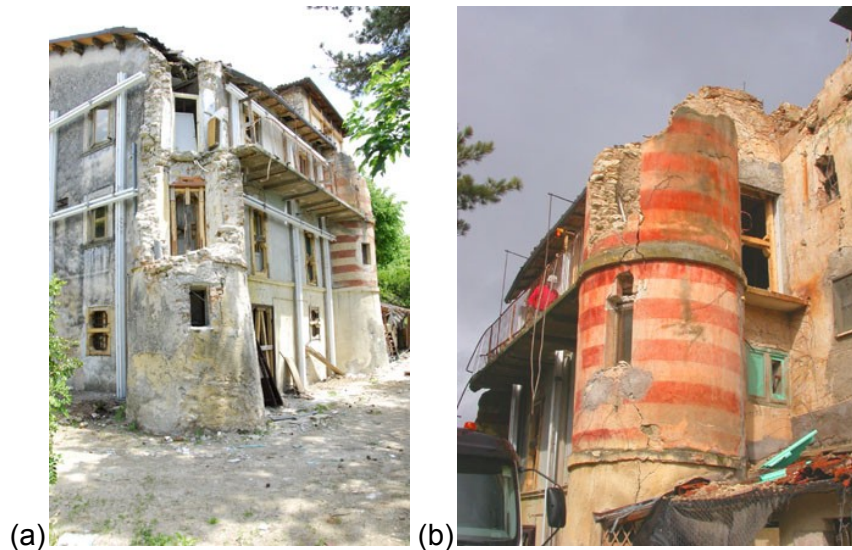
Fig. 6.2 Cortile interno: (a) facciata Sud-Ovest della casa canonica, (b) dettaglio di una delle torri angolari (Fotografie: Il Cenacolo S.r.l.)
