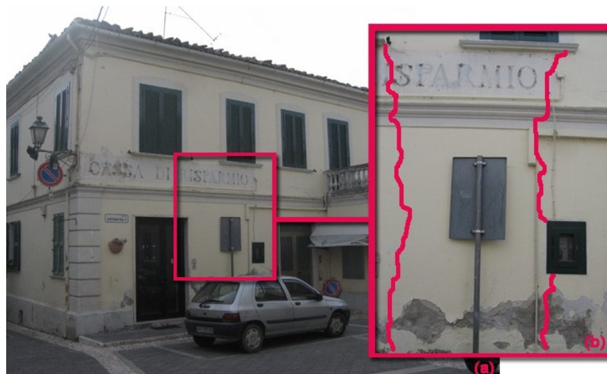
Fig. 5.55 U. S. 7: (a) Facciata su Piazza Umberto I, (b) Dettaglio delle lesioni
