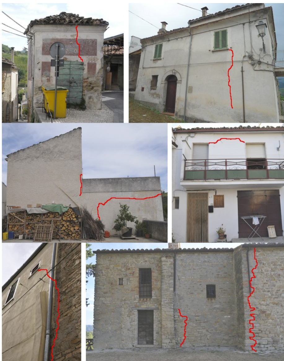
Fig. 4.38 Danneggiamenti nel piano riscontrati nell'edificio di Arsita (TE) (Fotografie: ENEA C. R. Bologna)
