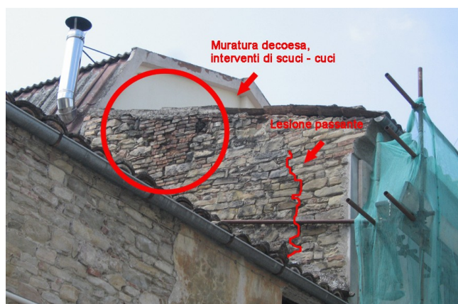
Fig. 4.44 Arsita (TE): danneggiamenti alle strutture verticali
