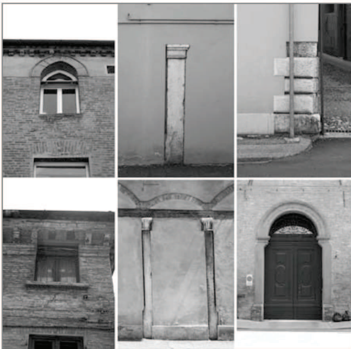
fig. 1. Ferrara, esempi di interventi sul costruito storico: incomprensioni del linguaggio edilizio preesistente.
