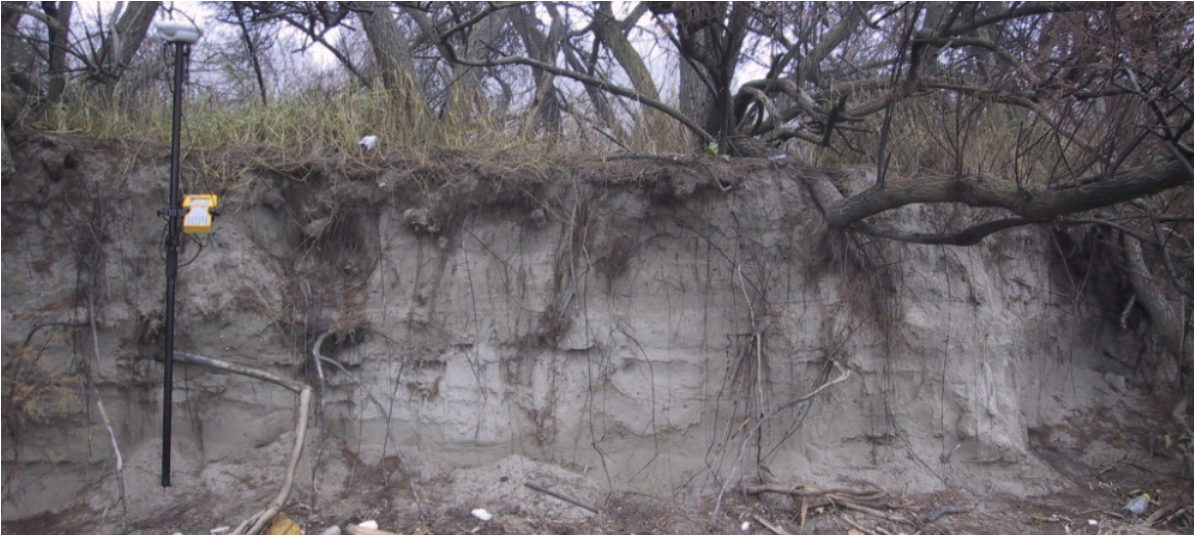
Figura 28 – Scarpata di erosione alta più di 1,5 m in corrispondenza di un tratto della duna di Lido delle Nazioni (prima della ricostruzione artificiale avvenuta nel 2007)
