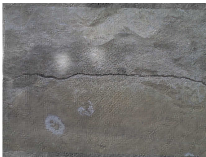
Immagine 68: immagine termica di identificazione di fessurazione
