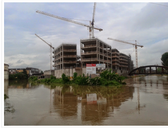
PIRUEA Ex Cotorossi: vista dell'area da sud in occasione della mancata alluvione del 17 maggio 2013. A sinistra il fiume Retrone e a destra il Bacchiglione. Fonte: F. Leder
