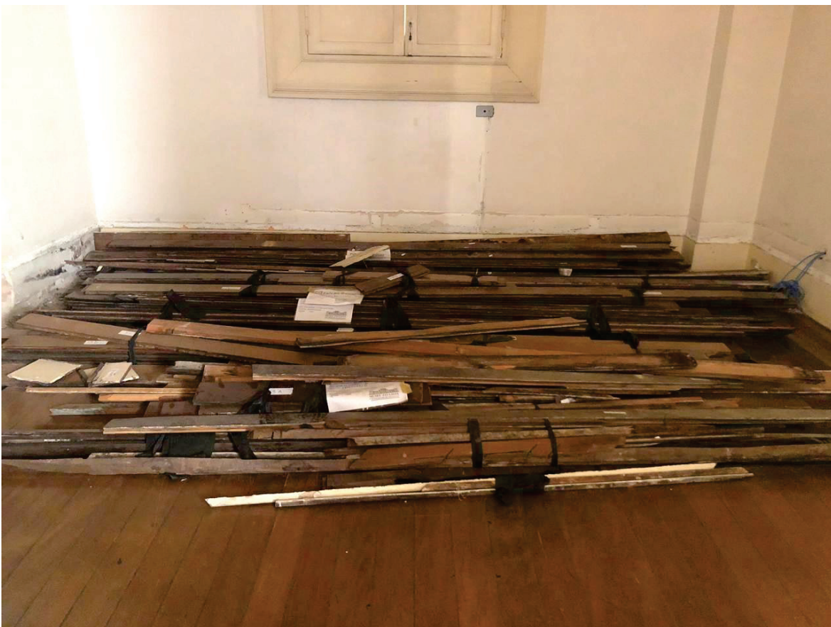
Figura 2.19. Peças de assoalho de madeira amontoadas em uma das salas do último pavimento da torre leste do edifício. Apesar da identificação e catalogação no momento da desmontagem, as janelas de prospecção permaneceram abertas por mais de um ano após a conclusão do diagnóstico estrutural.
