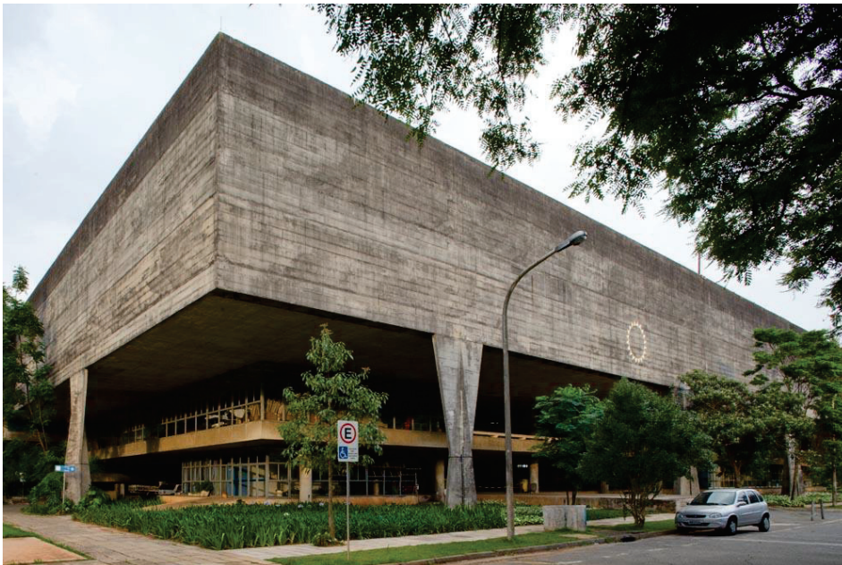
Figura 3.33. Empenas do edifício antes da campanha de recuperação. São identificadas distintas faixas de concretagem, dada a diferença de tonalidade da cor do concreto.
