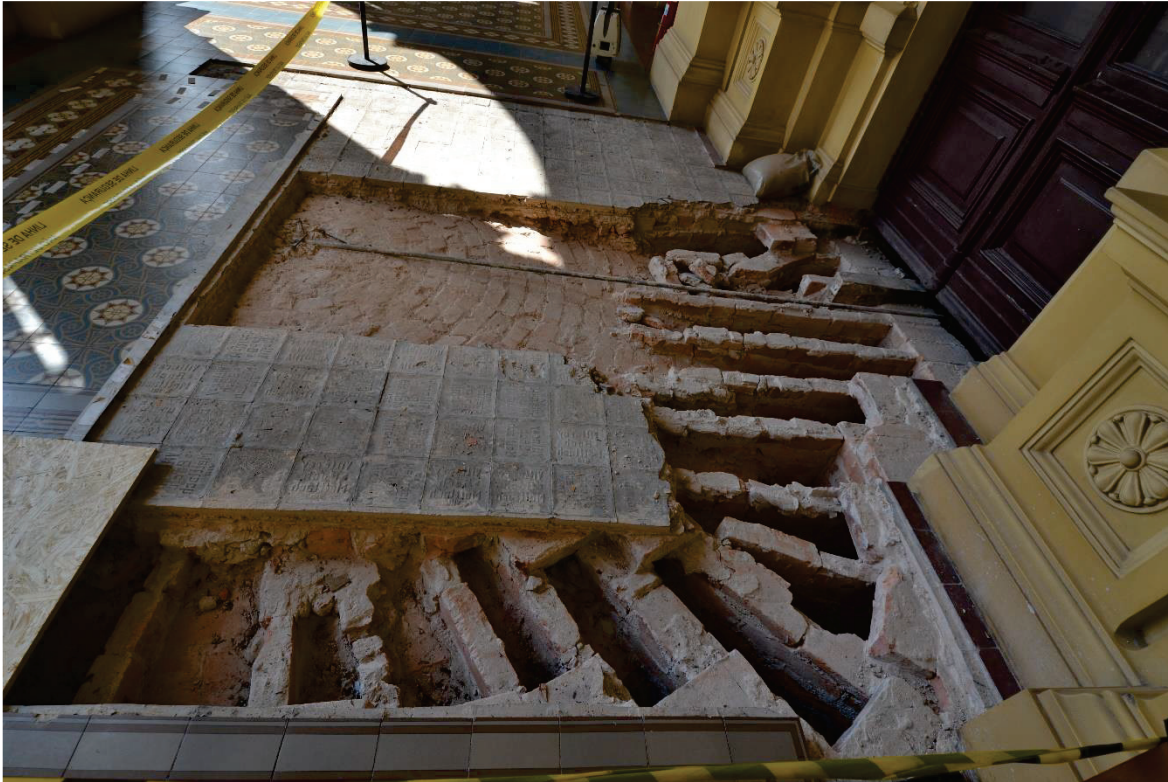
Figura 2.12. Abertura de janela de prospecção para investigação das soluções estruturais do edifício-monumento, que buscava identificar o sistema construtivo das abóbadas de tijolos das galerias do pavimento térreo. Na imagem, pavimentação de mosaicos em ladrilho hidráulico e argamassa retirados no primeiro pavimento.
