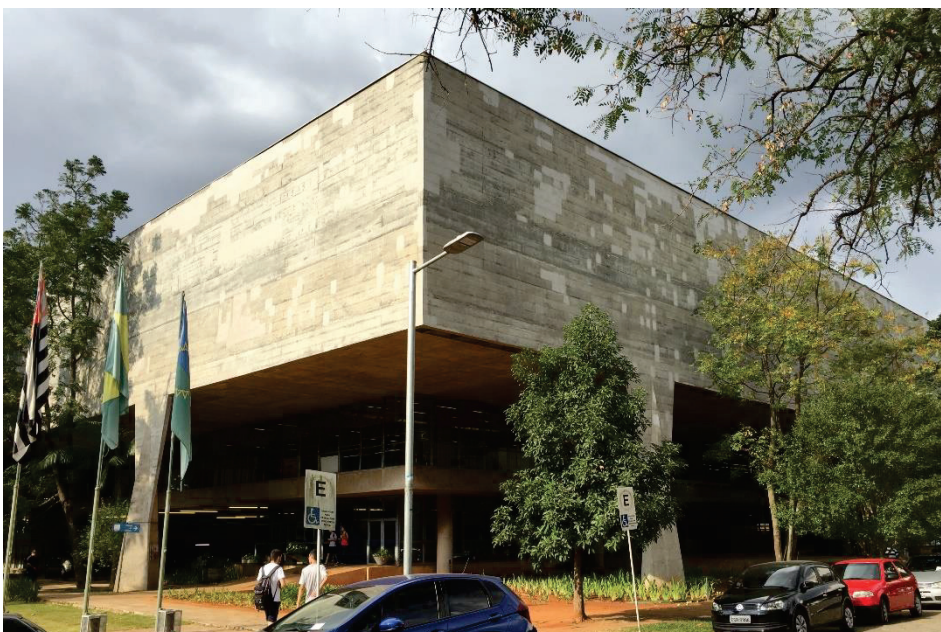
Figura 3.34. Empenas do edifício após a campanha de recuperação. Em meio às faixas de concretagem, destacam-se os reparos em argamassa distribuídos pelas superfícies.
