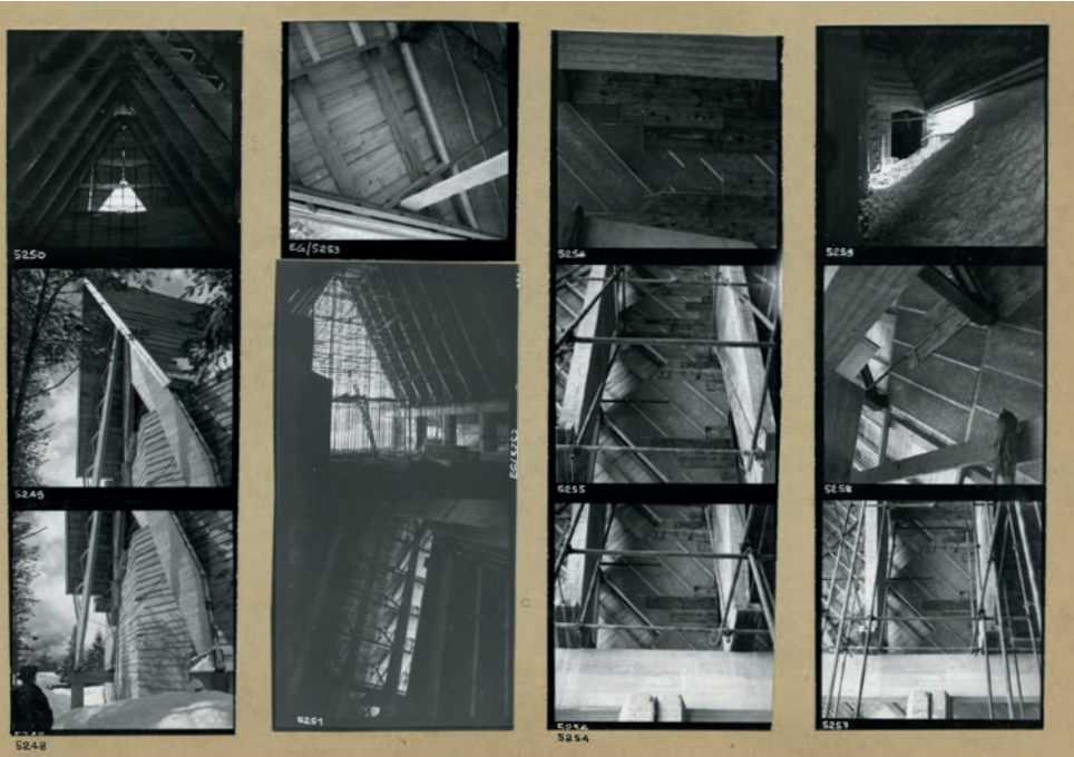
Fig.4 - Vedute del cantiere della costruzione della Chiesa di Nostra Signora al Villaggio di Corte di Cadore, Gellner, progettista dell'opera, Foglio 434 estratto dall'album 4 (foto 1960-61). © Università Iuav di Venezia, Archivio Progetti, fondo Edoardo Gellner
