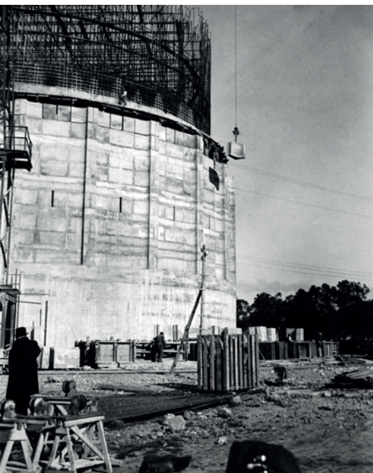
Fig. 5 - Cantiere del serbatoio: muratura con blocchi prefabbricati a piè d'opera, sollevati e adagiati da gru metallica (© ACS, 1937-38 circa)
