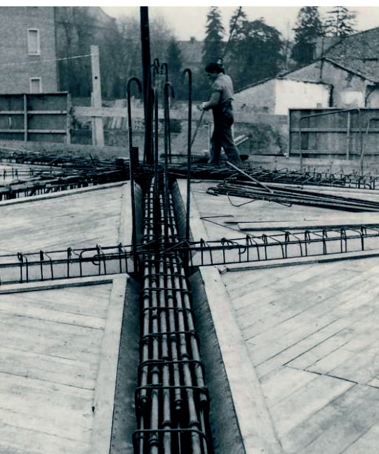
Fig.8 - Palazzo INA, particolare dell'armatura di una trave, zona dell'atrio, V stato di avanzamento 3 feb. 1958 (FACS, racc. 7, foto 260)
