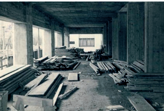
Fig.6 - Palazzo INA, pilastri esagonali e rettangolari lato viale Cavour, V stato di avanzamento 3 feb. 1958 (FACS, racc. 7, foto 255)
